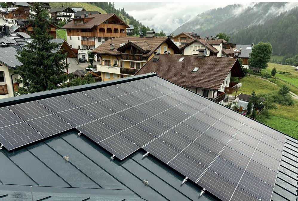
Söl frabicat dla scora da Lungiarü él gnü realisé n implant fotovoltaich
